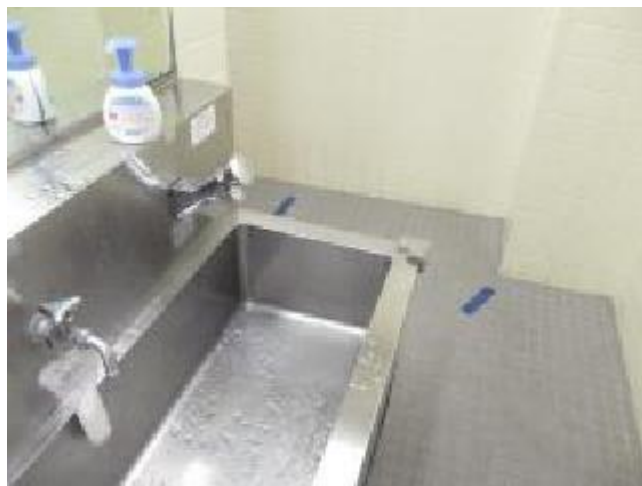
水道の蛇口が変わりました。
