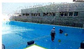
武道場上のプールです。ブルーが眩しいピカピカの仕上がりです。
